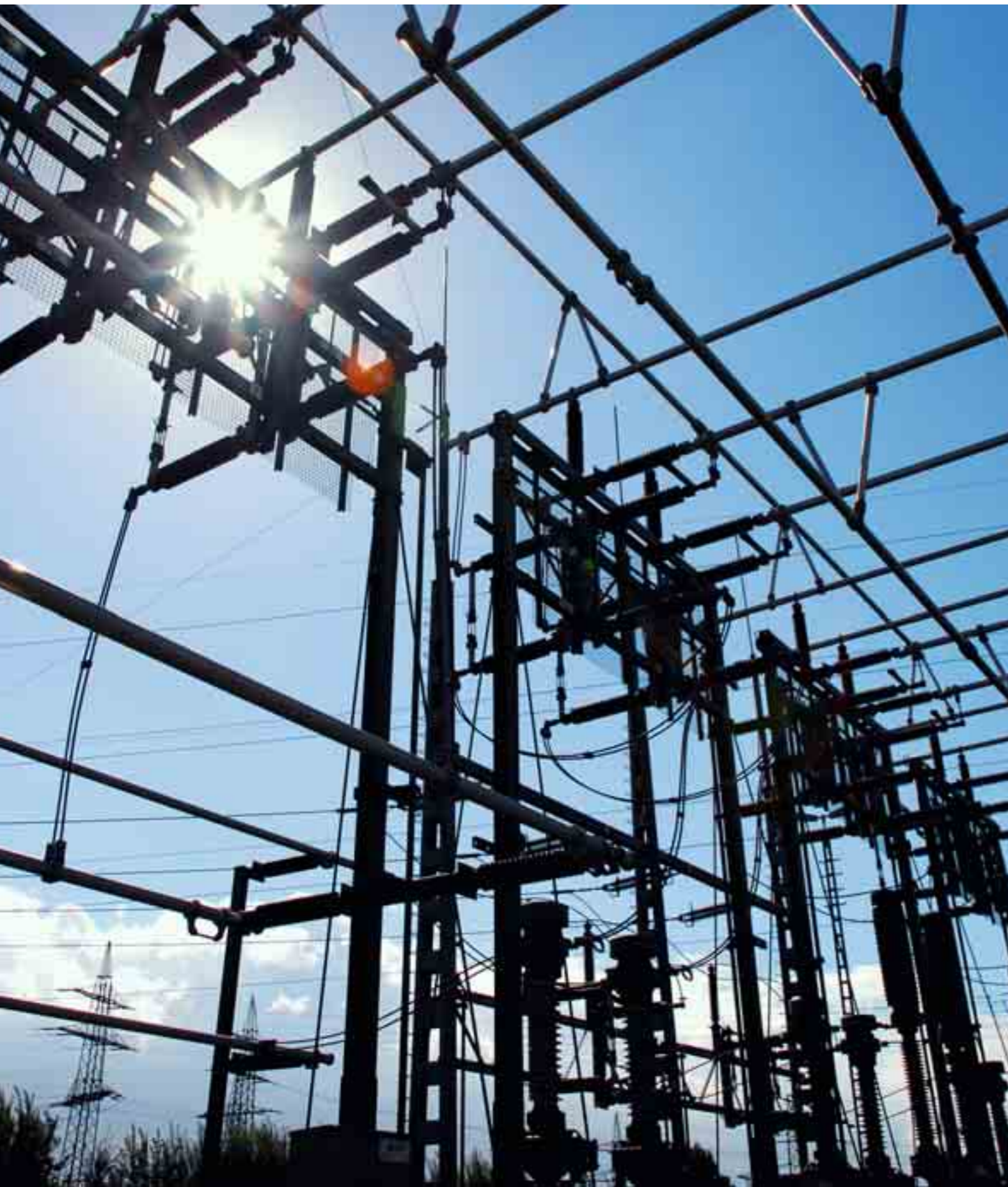
Freianlage Umrichterwerk, Limburg
